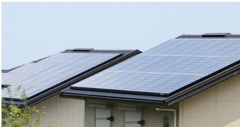
住宅に設置された太陽光発電のパネル
